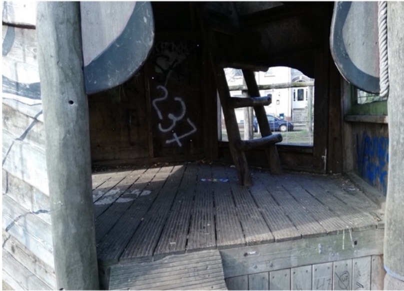
Abb. 30: Der schwer einsehbare Bereich des Rutschenturms wird als Toilette, Drogenversteck etc. genutzt, des Weiteren wird darin geraucht.
